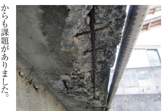
鉄骨がむき出し状態になっていた橋
